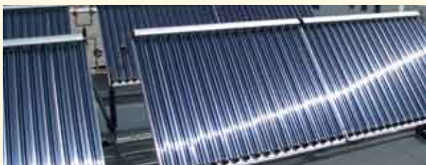
Une installation LATENTO sur le toit du Playmobil Funpark à Malte
